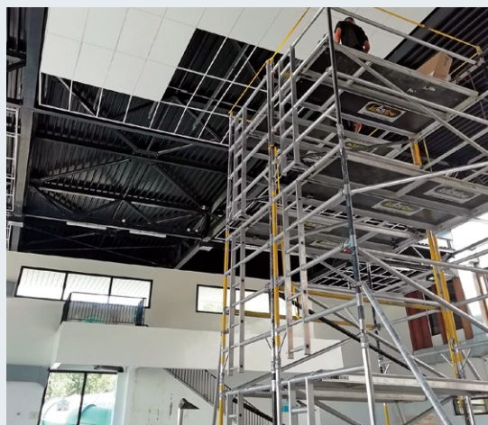
L'intervention sur les plaques de faux-plafond a nécessité la mise en place d'un échafaudage au sein de la piscine.
